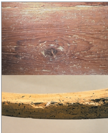
Slika 3: Poškodbe na lesu zaradi napada lesnih insektov
